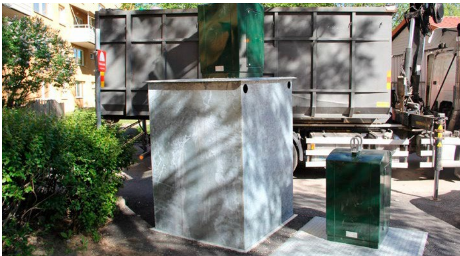
Tömning av bottentömmande behållare under jord. Bild: Södertälje kommun.
