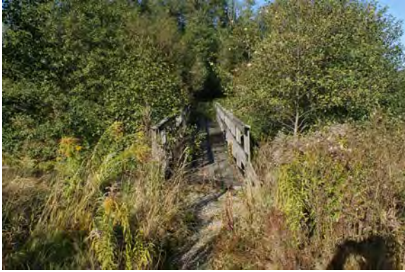
Foto 12. Igenväxt bro, förvaltningen bör återupptas.
